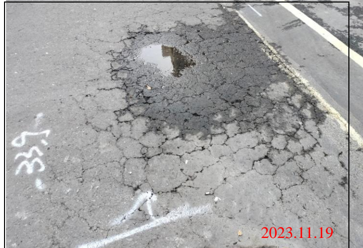
巡查日期地點：112.11.19/ Y23車站 照片說明：路面龜裂狀況
