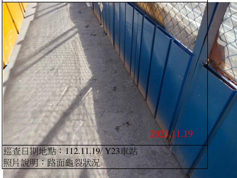
巡查日期地點：112.11.19/ Y23車站 照片說明：路面龜裂狀況
