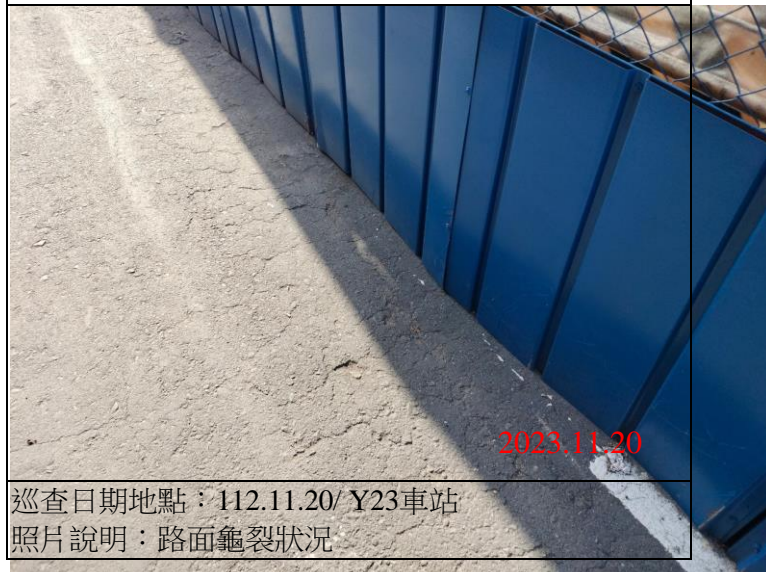
巡查日期地點：112.11.20/ Y23車站 照片說明：路面龜裂狀況
