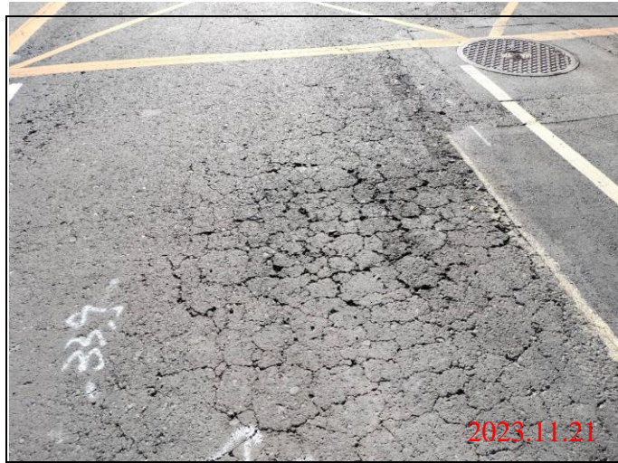
巡查日期地點：112.11.21/ Y23車站 照片說明：路面龜裂狀況
