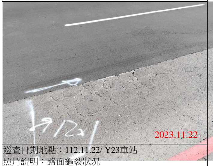
巡查日期地點：112.11.22/ Y23車站 照片說明：路面龜裂狀況
