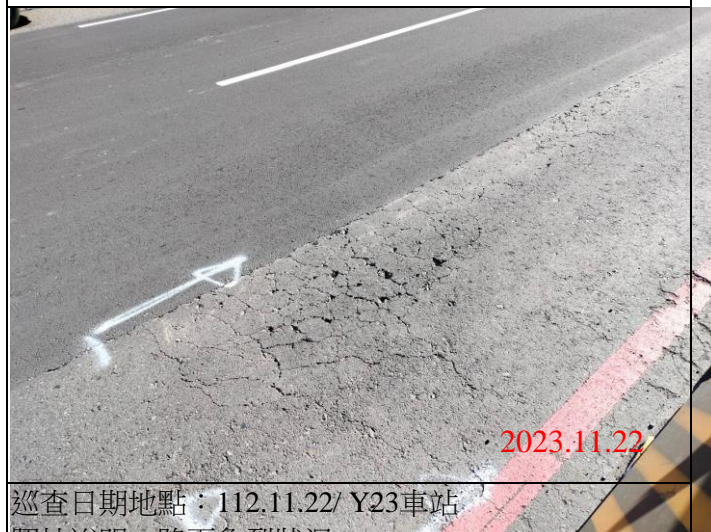
巡查日期地點：112.11.22/ Y23車站 照片說明：路面龜裂狀況
