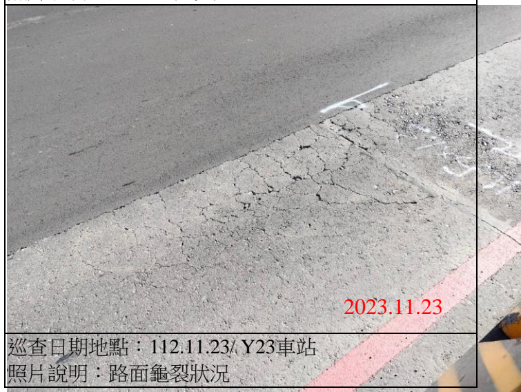
巡查日期地點：112.11.23/ Y23車站 照片說明：路面龜裂狀況
