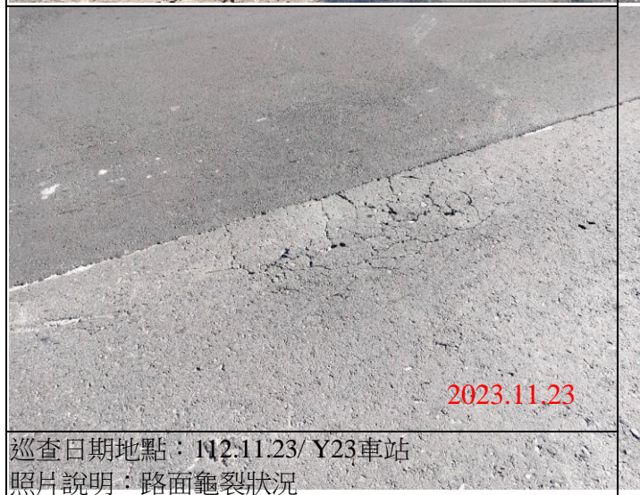
巡查日期地點：112.11.23/ Y23車站 照片說明：路面龜裂狀況
