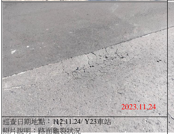
巡查日期地點：112.11.24/ Y23車站 照片說明：路面龜裂狀況
