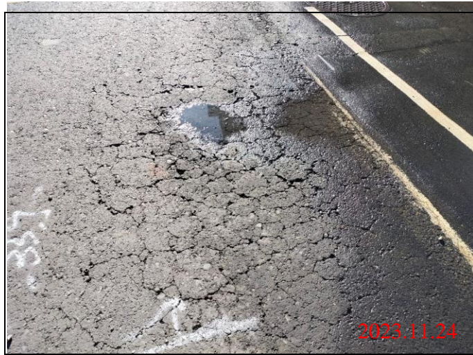
巡查日期地點：112.11.24/ Y23車站 照片說明：路面龜裂狀況
