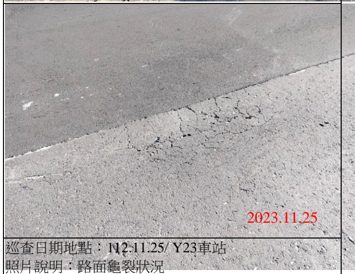
巡查日期地點：112.11.25/ Y23車站 照片說明：路面龜裂狀況
