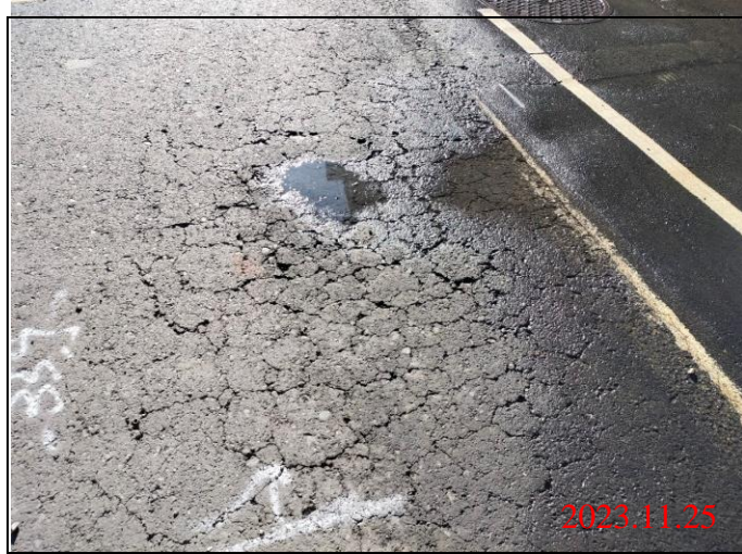
巡查日期地點：112.11.25/ Y23車站 照片說明：路面龜裂狀況
