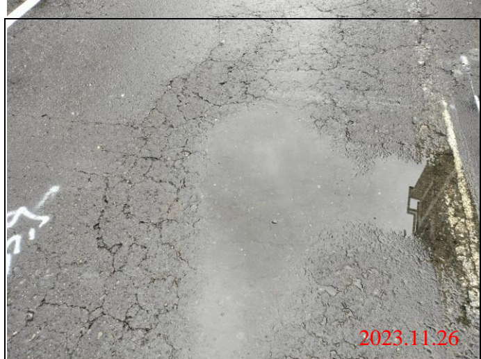
巡查日期地點：112.11.26/ Y23車站 照片說明：路面龜裂狀況
