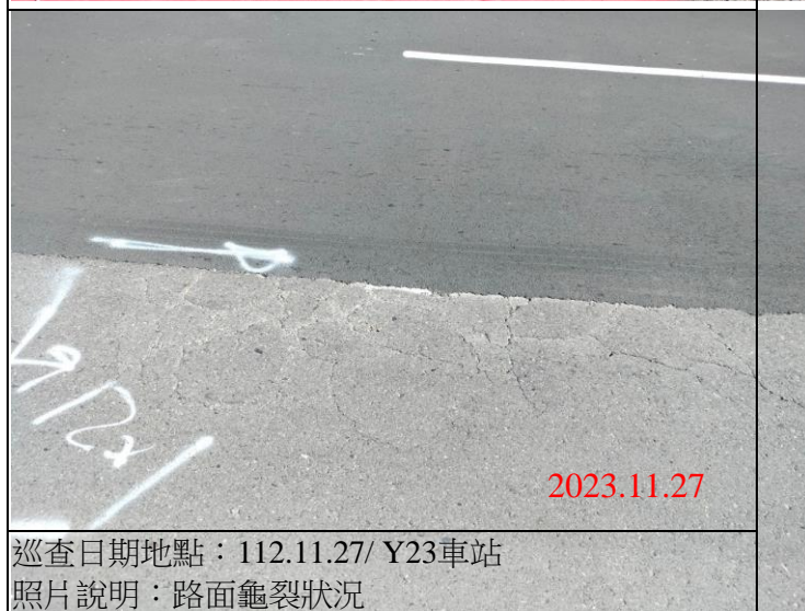
巡查日期地點：112.11.27/ Y23車站 照片說明：路面龜裂狀況
