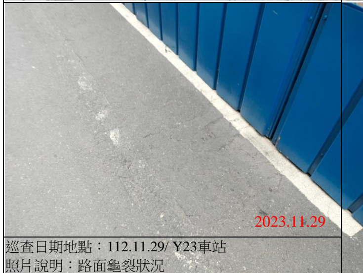
巡查日期地點：112.11.29/ Y23車站 照片說明：路面龜裂狀況
