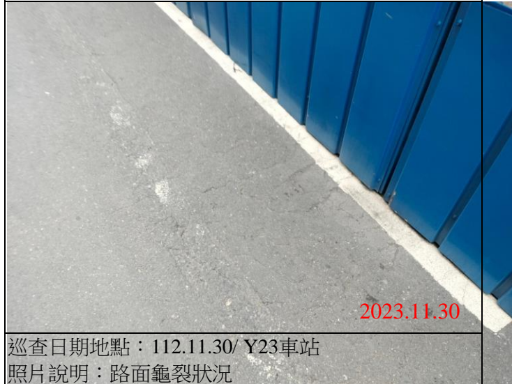
巡查日期地點：112.11.30/ Y23車站 照片說明：路面龜裂狀況
