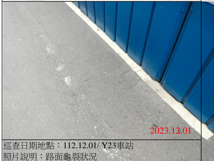
巡查日期地點：112.12.01/ Y23車站 照片說明：路面龜裂狀況
