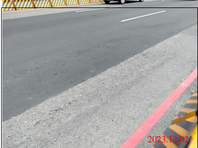
巡查日期地點：112.12.02/ Y23車站 照片說明：路面龜裂狀況
