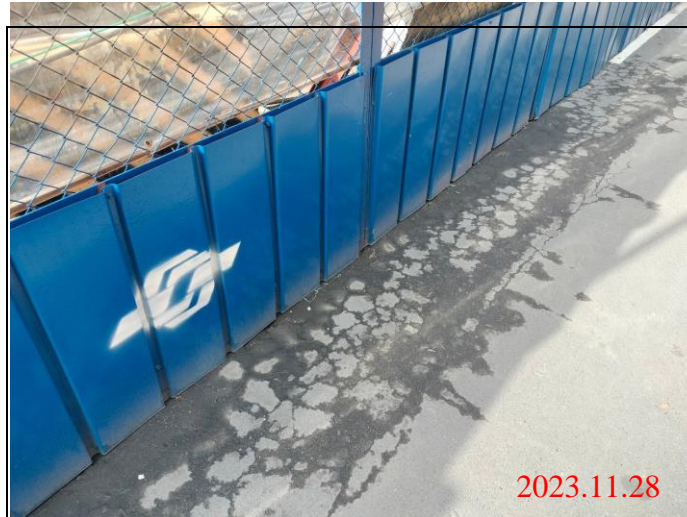
巡查日期地點：112.11.28/-Y23車站 照片說明：路面龜裂狀況
