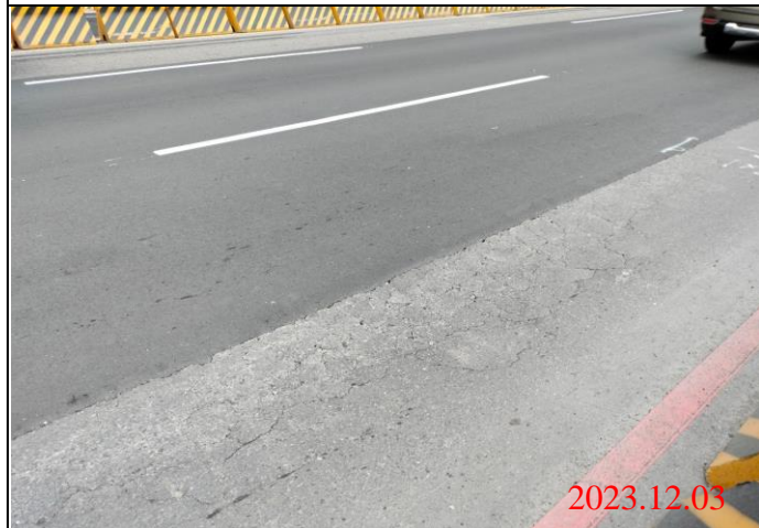
巡查日期地點：112.12.03/ Y23車站 照片說明：路面龜裂狀況
