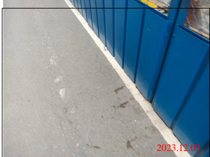
巡查日期地點：112.12.03/ Y23車站 照片說明：路面龜裂狀況
