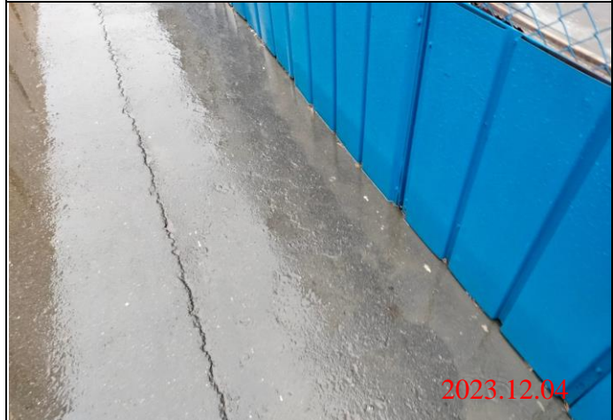
巡查日期地點：112.12.04/ Y23車站 照片說明：路面龜裂狀況
