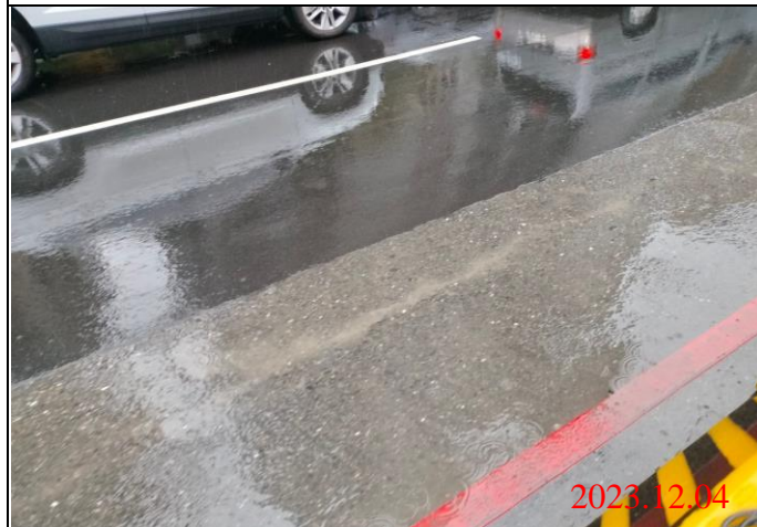
巡查日期地點：112.12.04/ Y23車站 照片說明：路面龜裂狀況
