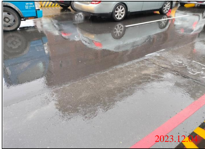
巡查日期地點：112.12.04/-Y23車站 照片說明：路面龜裂狀況
