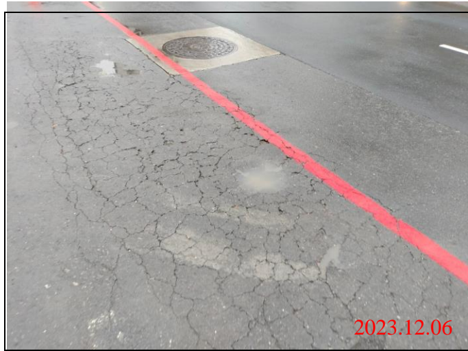
巡查日期地點：112.12.06/ Y23車站 照片說明：路面龜裂狀況
