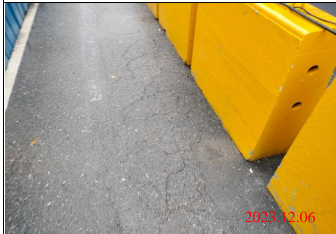
巡查日期地點：112.12.06/ Y23車站 照片說明：路面龜裂狀況
