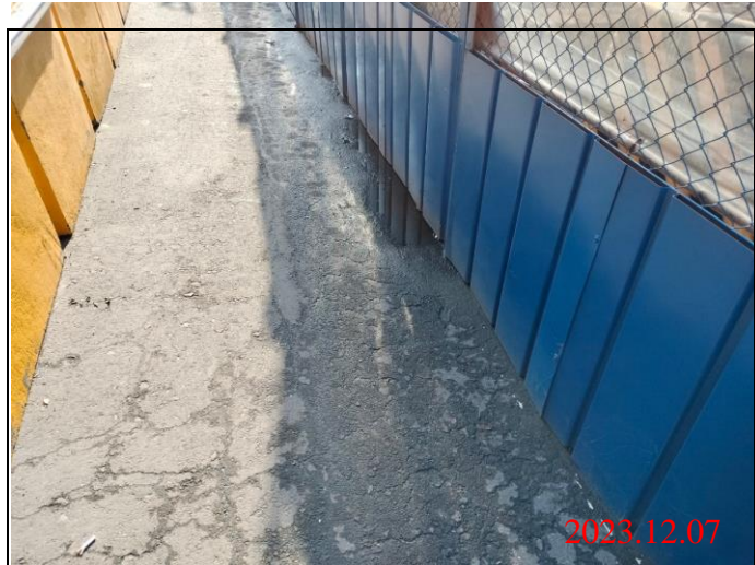
巡查日期地點：112.12.07/-Y23車站 照片說明：路面龜裂狀況
