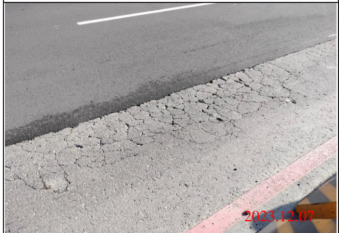
巡查日期地點：112.12.07/ Y23車站 照片說明：路面龜裂狀況
