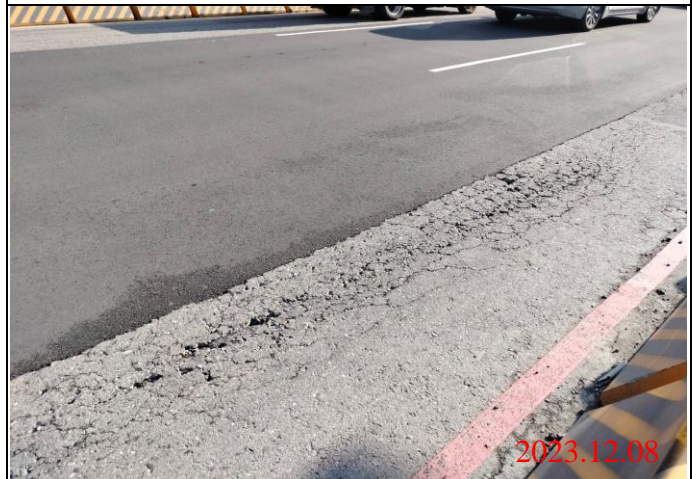
巡查日期地點：112.12.08/ Y23車站 照片說明：路面龜裂狀況
