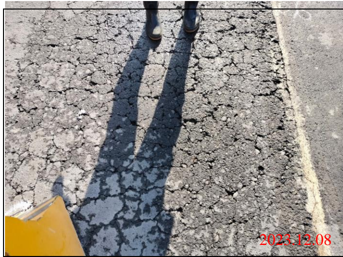
巡查日期地點：112.12.08/ Y23車站 照片說明：路面龜裂狀況
