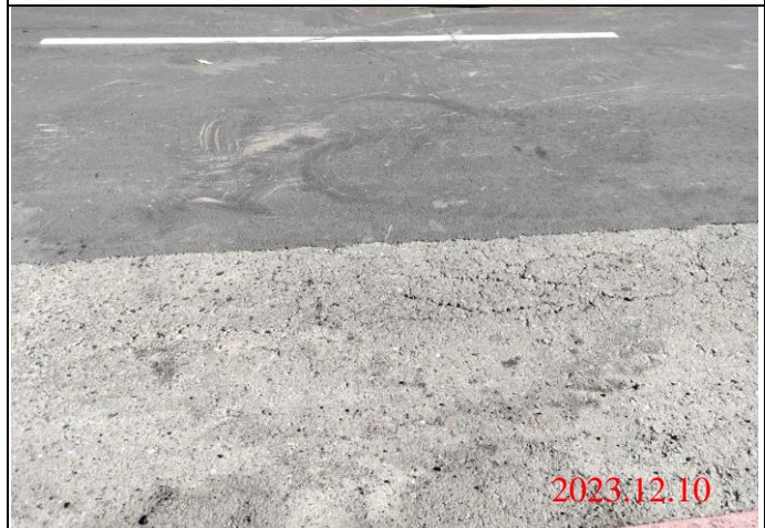
巡查日期地點：112.12.10/ Y23車站 照片說明：路面龜裂狀況
