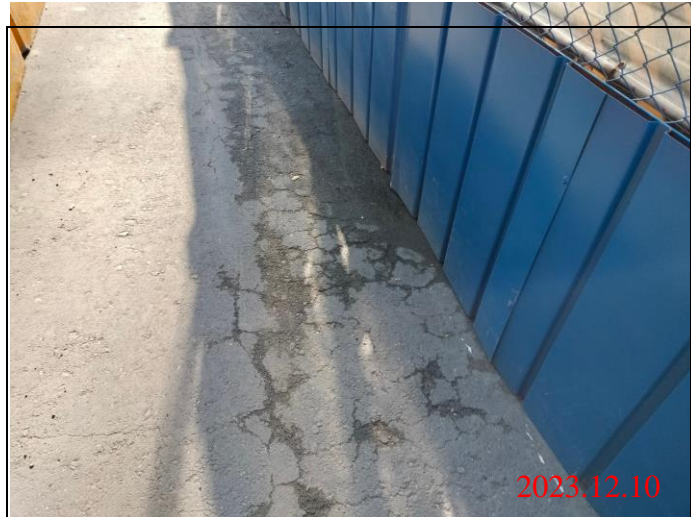
巡查日期地點：112.12.10/-Y23車站 照片說明：路面龜裂狀況
