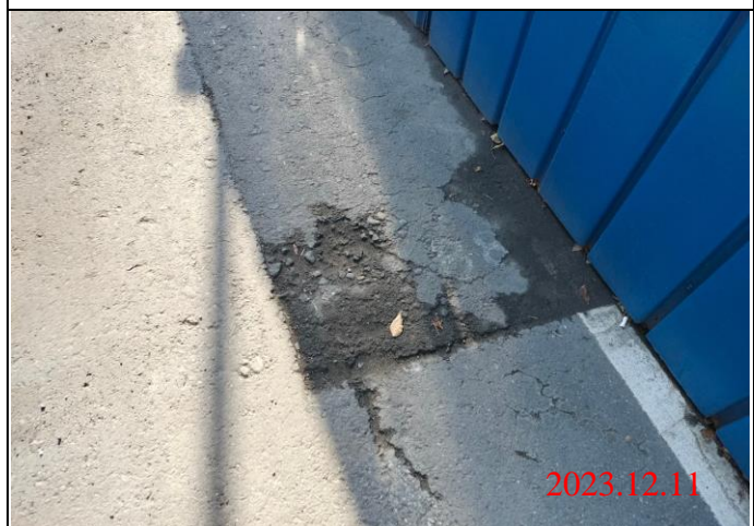
巡查日期地點：112.12.11/ Y23車站 照片說明：路面龜裂狀況
