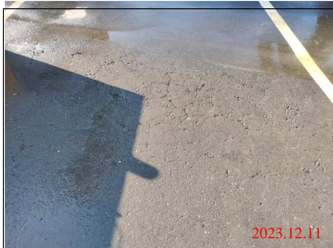
巡查日期地點：112.12.11/ Y23車站 照片說明：路面龜裂狀況
