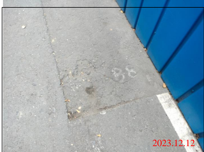
巡查日期地點：112.12.12/-Y23車站 照片說明：路面龜裂狀況
