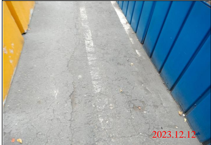
巡查日期地點：112.12.12/ Y23車站 照片說明：路面龜裂狀況
