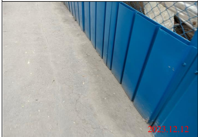
巡查日期地點：112.12.12/ Y23車站 照片說明：路面龜裂狀況
