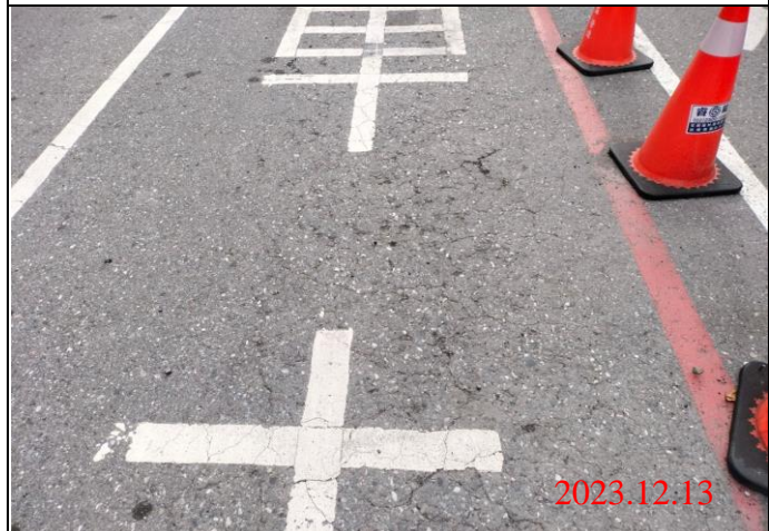
巡查日期地點：112.12.13/ Y23車站 照片說明：路面龜裂狀況
