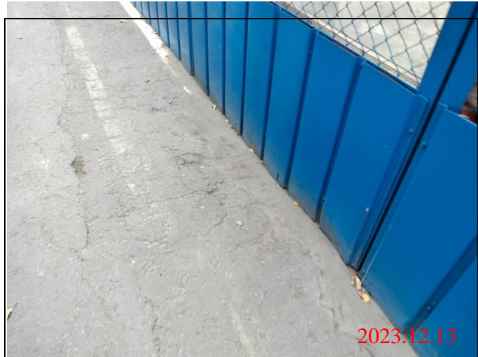
巡查日期地點：112.12.13/-Y23車站 照片說明：路面龜裂狀況
