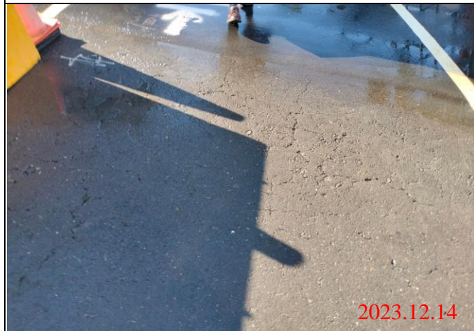
巡查日期地點：112.12.14/ Y23車站 照片說明：路面龜裂狀況
