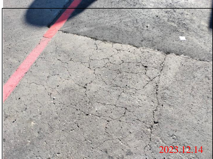
巡查日期地點：112.12.14/ Y23車站 照片說明：路面龜裂狀況
