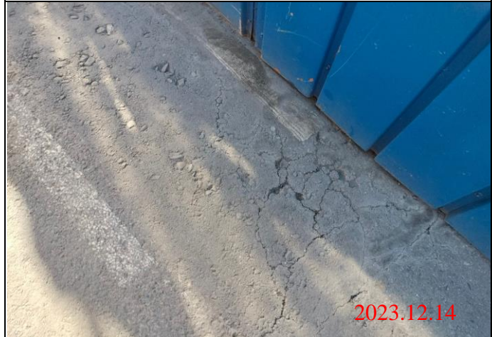
巡查日期地點：112.12.14/ Y23車站 照片說明：路面龜裂狀況
