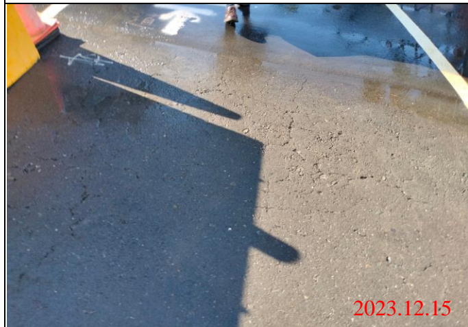
巡查日期地點：112.12.15/ Y23車站 照片說明：路面龜裂狀況
