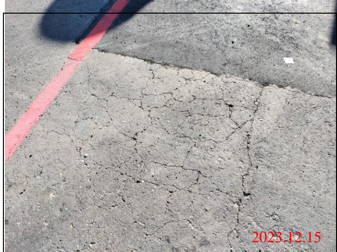
巡查日期地點：112.12.15/ Y23車站 照片說明：路面龜裂狀況
