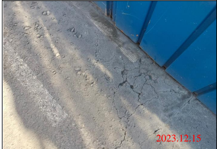
巡查日期地點：112.12.15/ Y23車站 照片說明：路面龜裂狀況
