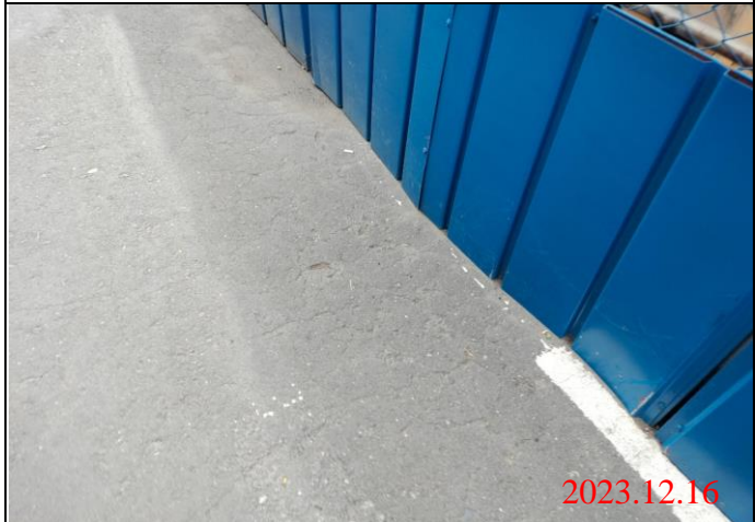
巡查日期地點：112.12.16/ Y23車站 照片說明：路面龜裂狀況
