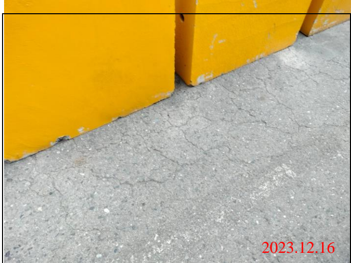
巡查日期地點：112.12.16/ Y23車站 照片說明：路面龜裂狀況
