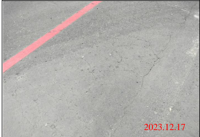
巡查日期地點：112.12.17/ Y23車站 照片說明：路面龜裂狀況
