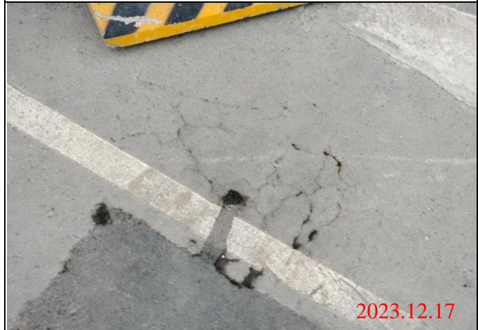
巡查日期地點：112.12.17/ Y23車站 照片說明：路面龜裂狀況
