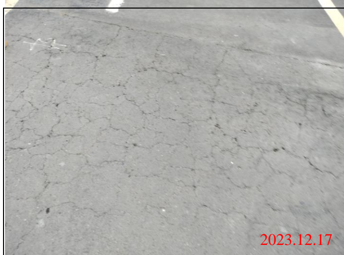
巡查日期地點：112.12.17/ Y23車站 照片說明：路面龜裂狀況
