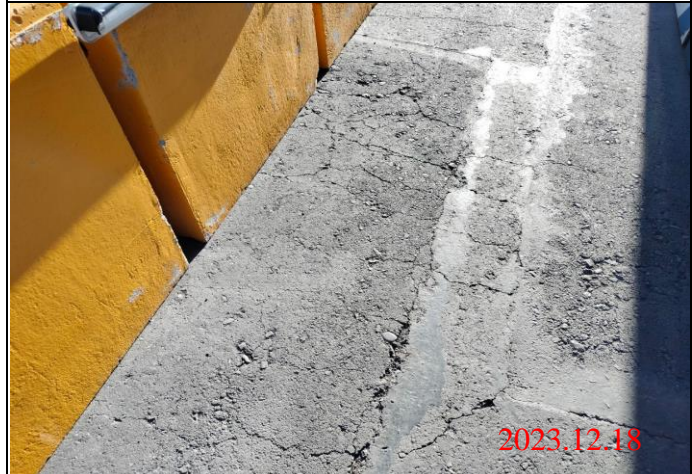
巡查日期地點：112.12.18/ Y23車站 照片說明：路面龜裂狀況
