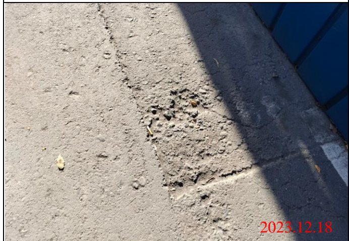
巡查日期地點：112.12.18/ Y23車站 照片說明：路面龜裂狀況
