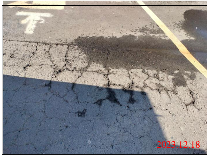
巡查日期地點：112.12.18/ Y23車站 照片說明：路面龜裂狀況
