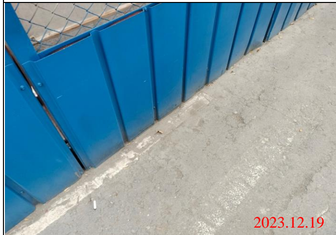
巡查日期地點：112.12.19/ Y23車站 照片說明：路面龜裂狀況
