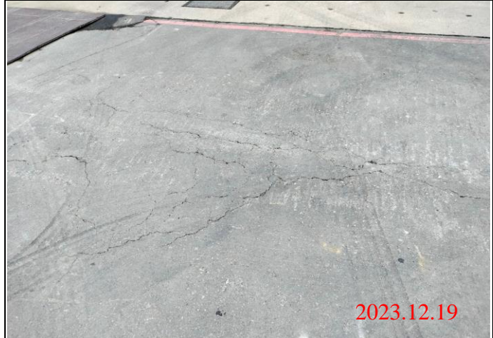
巡查日期地點：112.12.19/ Y23車站 照片說明：路面龜裂狀況
