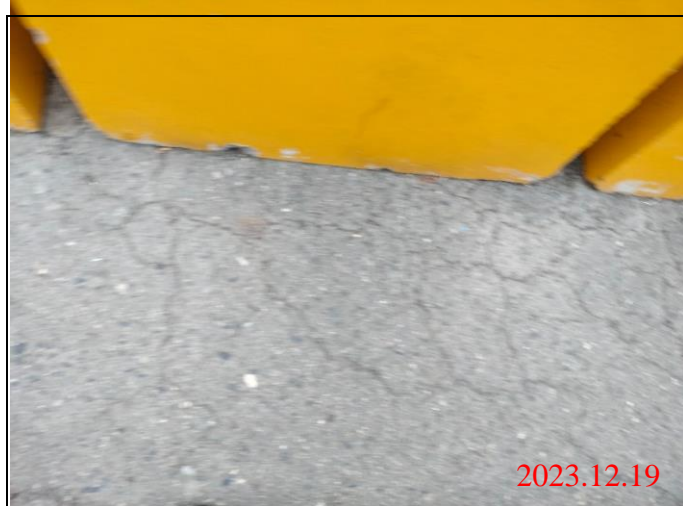
巡查日期地點：112.12.19/ Y23車站 照片說明：路面龜裂狀況
