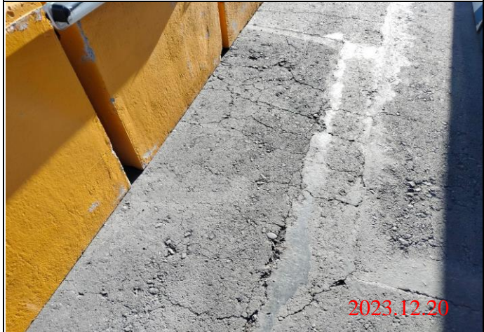
巡查日期地點：112.12.20/ Y23車站 照片說明：路面龜裂狀況
