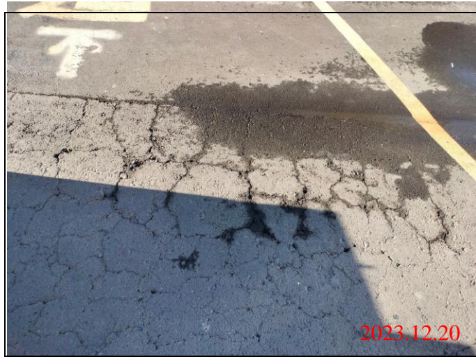
巡查日期地點：112.12.20/ Y23車站 照片說明：路面龜裂狀況
