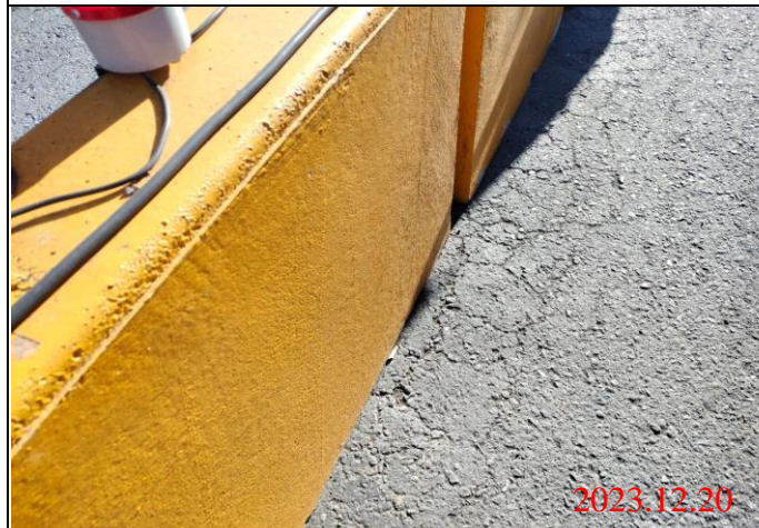
巡查日期地點：112.12.20/ Y23車站 照片說明：路面龜裂狀況
