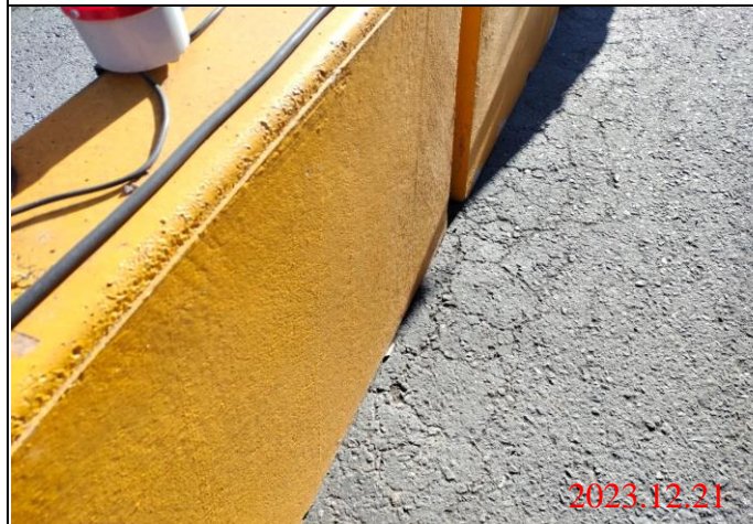
巡查日期地點：112.12.21/ Y23車站 照片說明：路面龜裂狀況
