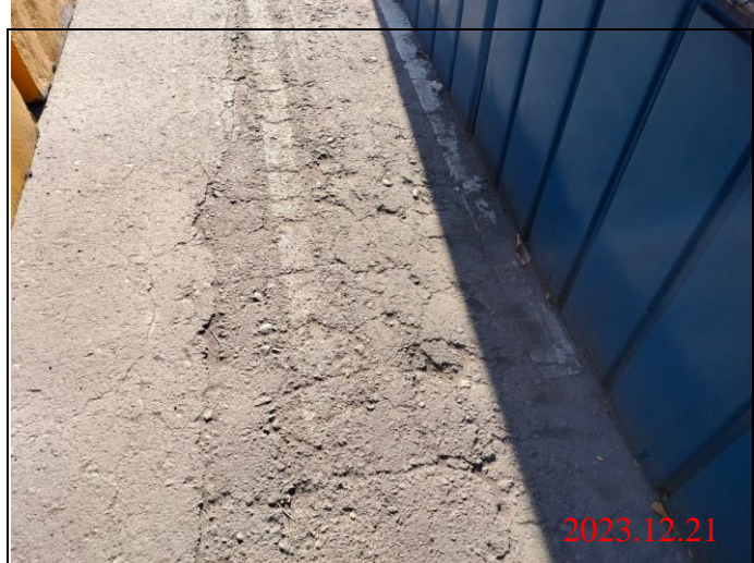
巡查日期地點：112.12.21/ Y23車站 照片說明：路面龜裂狀況
