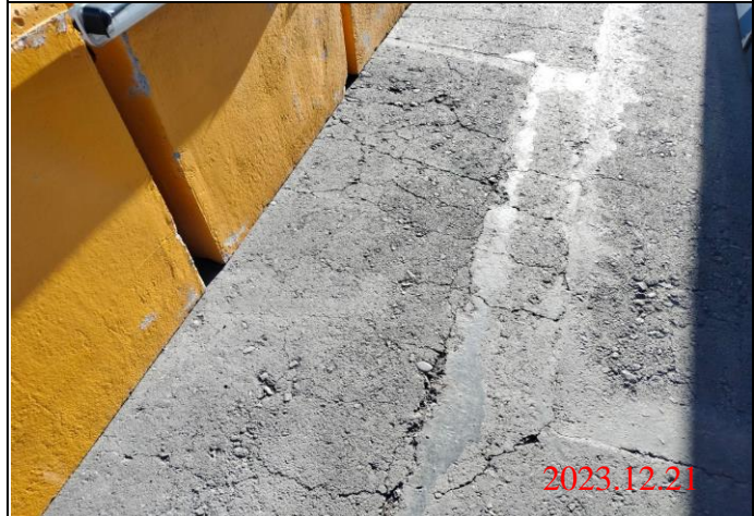
巡查日期地點：112.12.21/ Y23車站 照片說明：路面龜裂狀況
