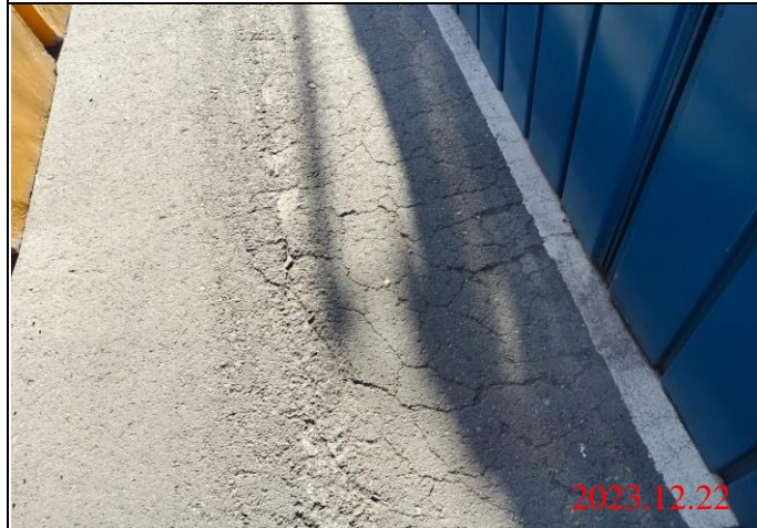
巡查日期地點：112.12.22/ Y23車站 照片說明：路面龜裂狀況
