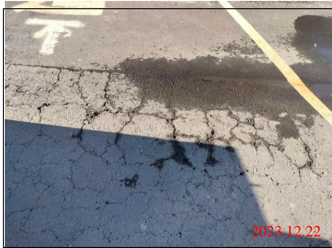
巡查日期地點：112.12.22/ Y23車站 照片說明：路面龜裂狀況
