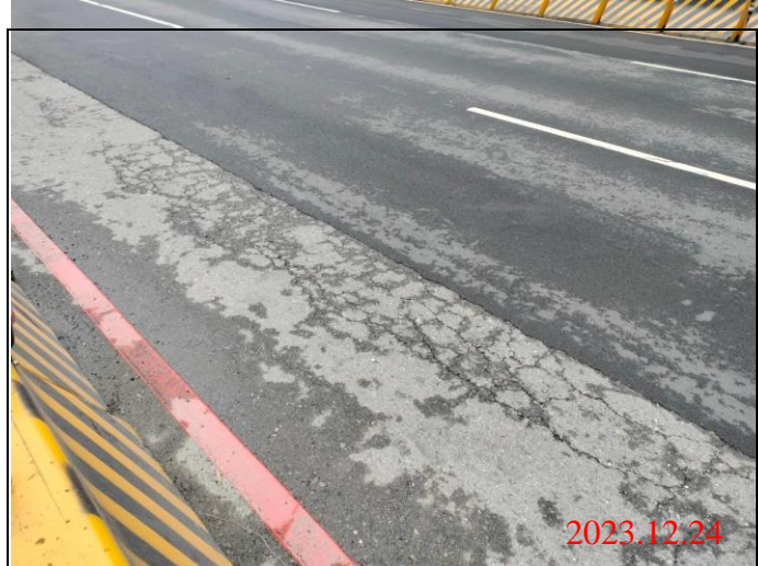
巡查日期地點：112.12.24/ Y23車站 照片說明：路面龜裂狀況
