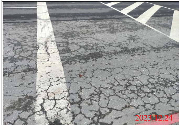
巡查日期地點：112.12.24/ Y23車站 照片說明：路面龜裂狀況
