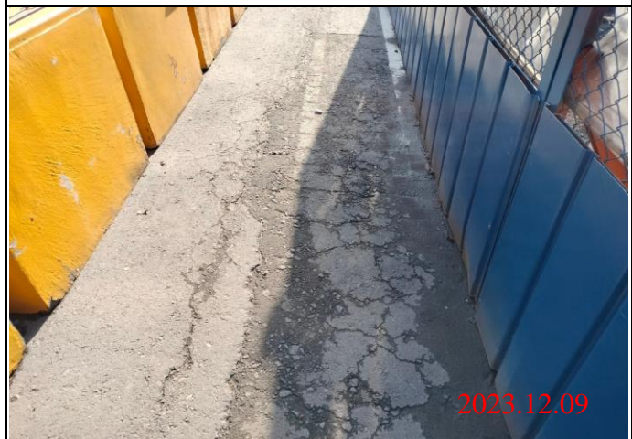
巡查日期地點：112.12.09/ Y23車站 照片說明：路面龜裂狀況
