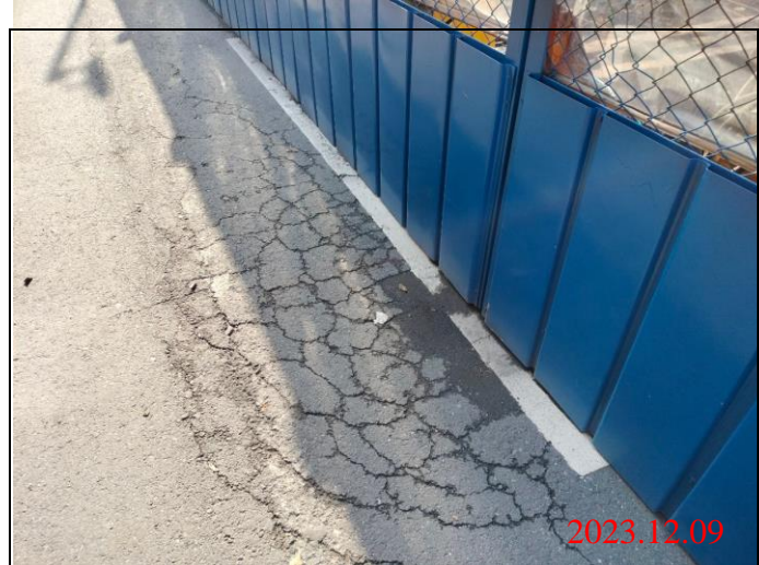
巡查日期地點：112.12.09/ Y23車站 照片說明：路面龜裂狀況
