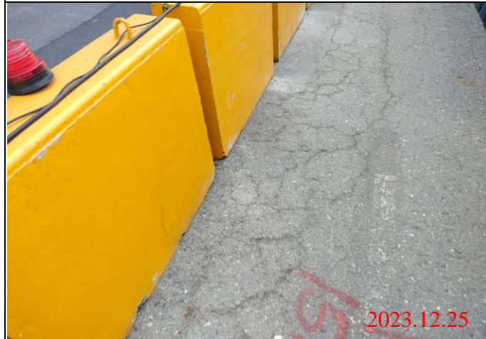
巡查日期地點：112.12.25/ Y23車站 照片說明：路面龜裂狀況
