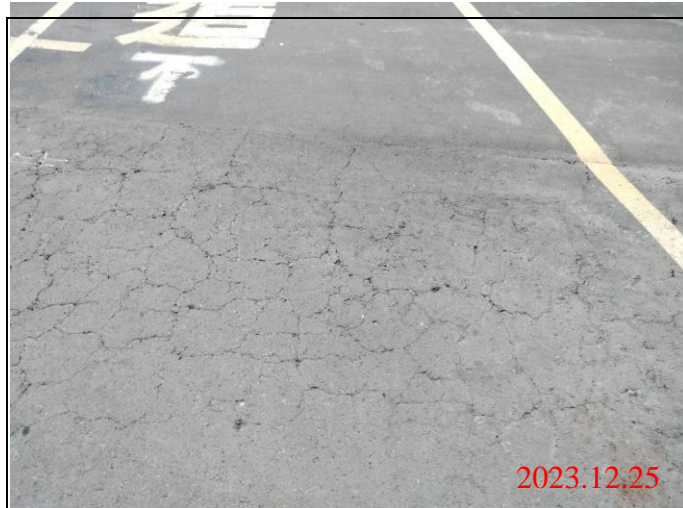
巡查日期地點：112.12.25/ Y23車站 照片說明：路面龜裂狀況
