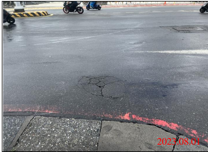
巡查日期地點：112.08.01/ Y21車站 照片說明：路面龜裂狀況
