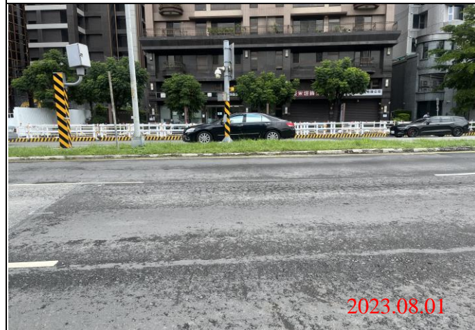
巡查日期地點：112.08.01/ Y23車站 照片說明：路面龜裂狀況
