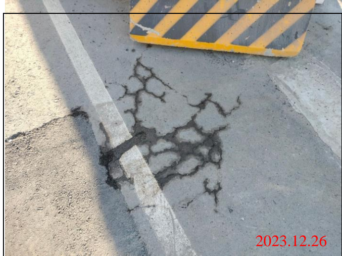
巡查日期地點：112.12.26/ Y23車站 照片說明：路面龜裂狀況
