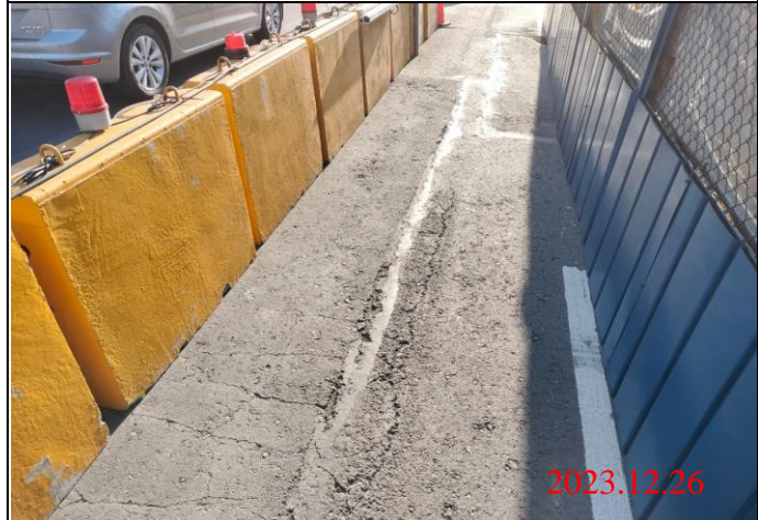
巡查日期地點：112.12.26/ Y23車站 照片說明：路面龜裂狀況
