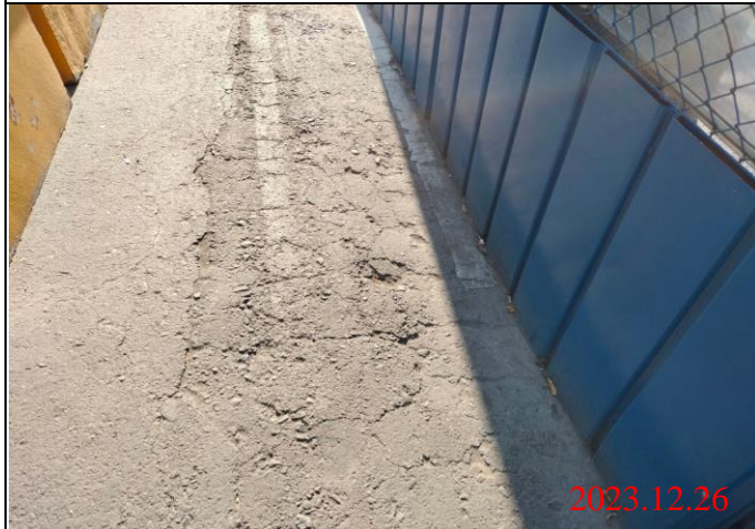
巡查日期地點：112.12.26/ Y23車站 照片說明：路面龜裂狀況
