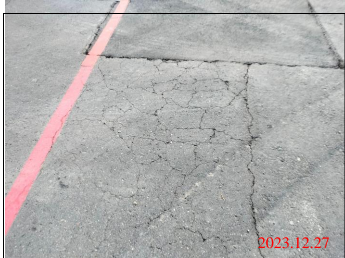
巡查日期地點：112.12.27/ Y23車站 照片說明：路面龜裂狀況
