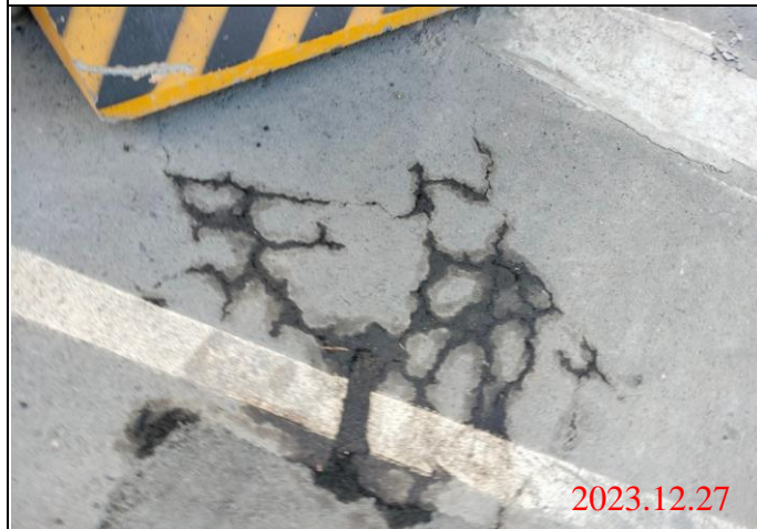
巡查日期地點：112.12.27/ Y23車站 照片說明：路面龜裂狀況
