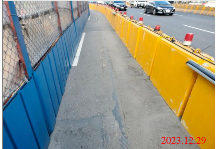
巡查日期地點：112.12.29/ Y23車站 照片說明：路面龜裂狀況
