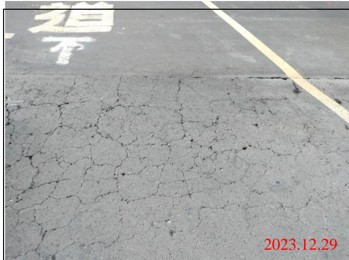
巡查日期地點：112.12.29/ Y23車站 照片說明：路面龜裂狀況
