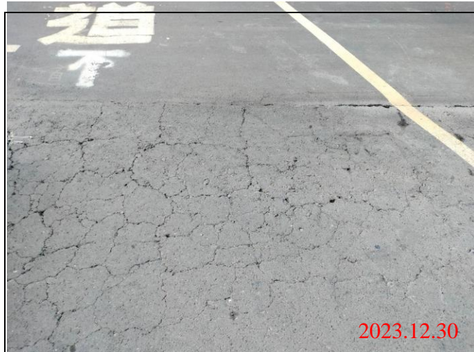
巡查日期地點：112.12.30/ Y23車站 照片說明：路面龜裂狀況
