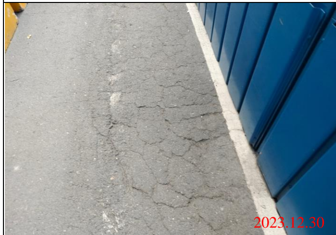
巡查日期地點：112.12.30/ Y23車站 照片說明：路面龜裂狀況
