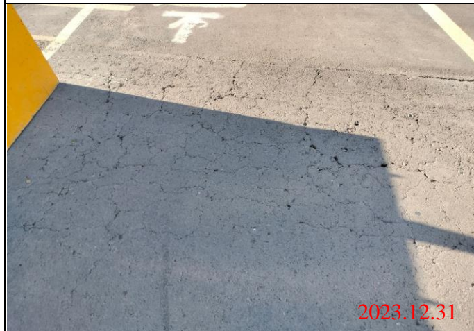
巡查日期地點：112.12.31/ Y23車站 照片說明：路面龜裂狀況
