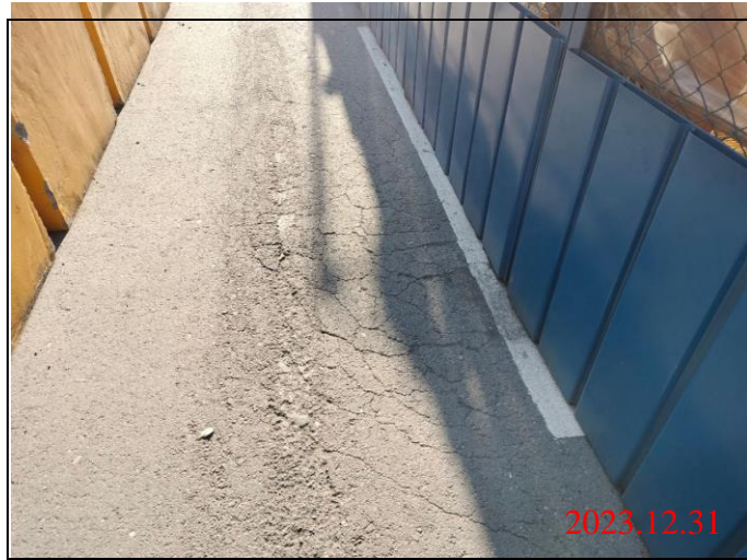
巡查日期地點：112.12.31/ Y23車站 照片說明：路面龜裂狀況
