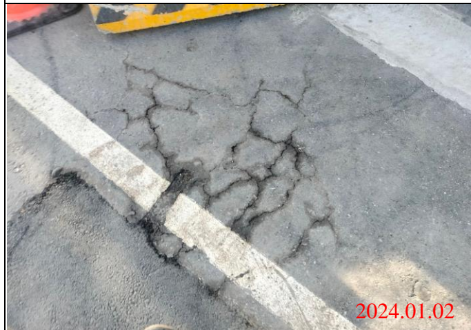
巡查日期地點：113.01.02/ Y23車站 照片說明：路面龜裂狀況
