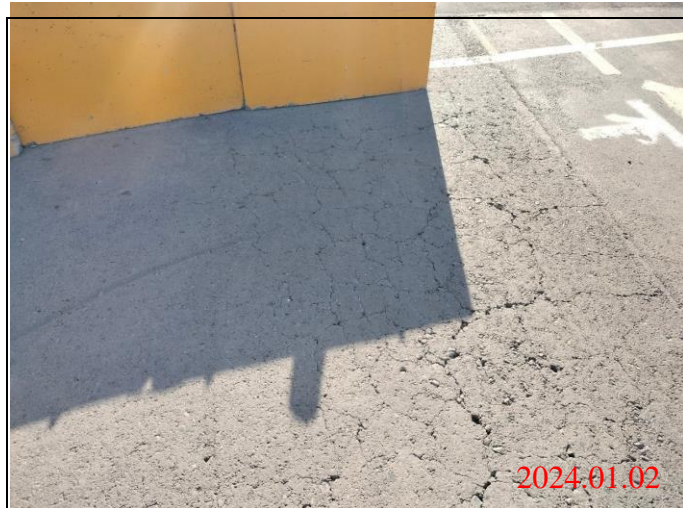
巡查日期地點：113.01.02/ Y23車站 照片說明：路面龜裂狀況
