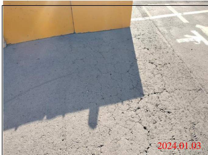
巡查日期地點：113.01.03/ Y23車站 照片說明：路面龜裂狀況
