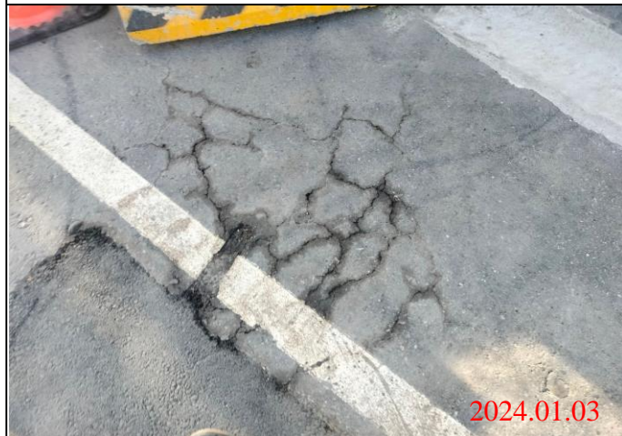
巡查日期地點：113.01.03/ Y23車站 照片說明：路面龜裂狀況
