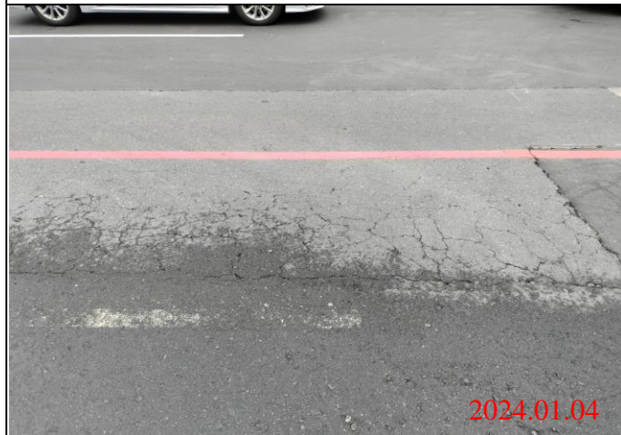
巡查日期地點：113.01.04/ Y23車站 照片說明：路面龜裂狀況
