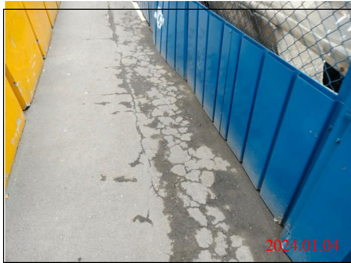
巡查日期地點：113.01.04/ Y23車站 照片說明：路面龜裂狀況
