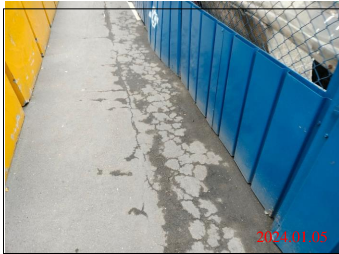
巡查日期地點：113.01.05/ Y23車站 照片說明：路面龜裂狀況
