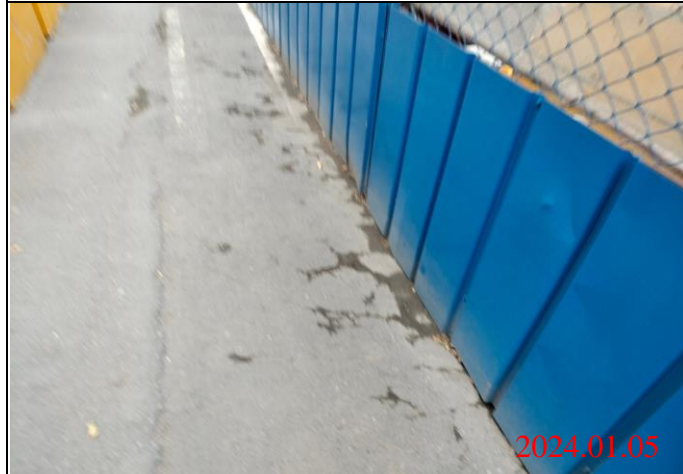
巡查日期地點：113.01.05/ Y23車站 照片說明：路面龜裂狀況
