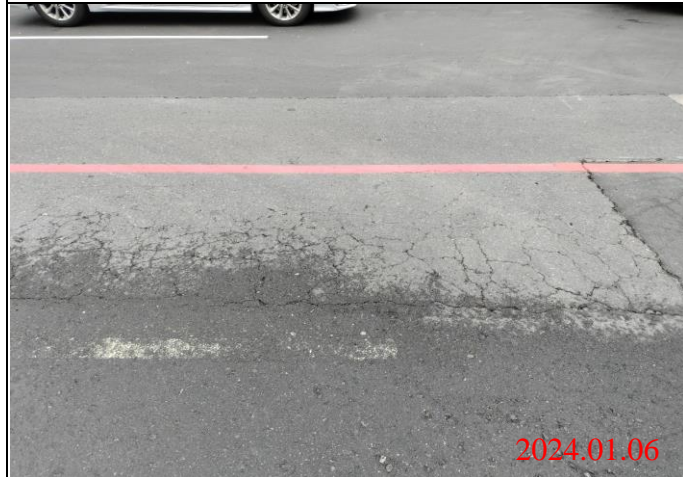
巡查日期地點：113.01.06/ Y23車站 照片說明：路面龜裂狀況
