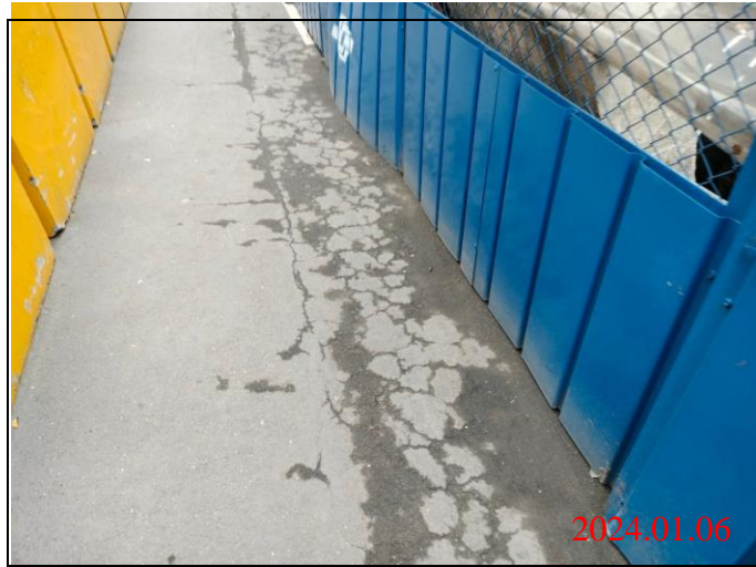
巡查日期地點：113.01.06/ Y23車站 照片說明：路面龜裂狀況
