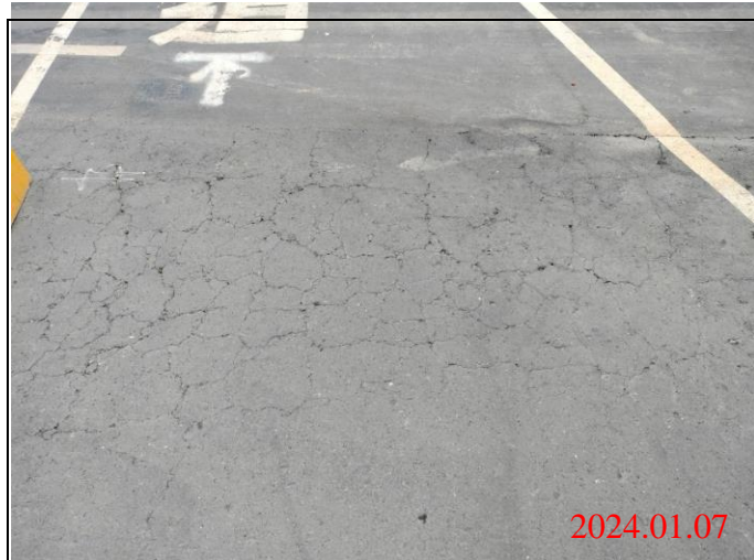
巡查日期地點：113.01.07/ Y23車站 照片說明：路面龜裂狀況
