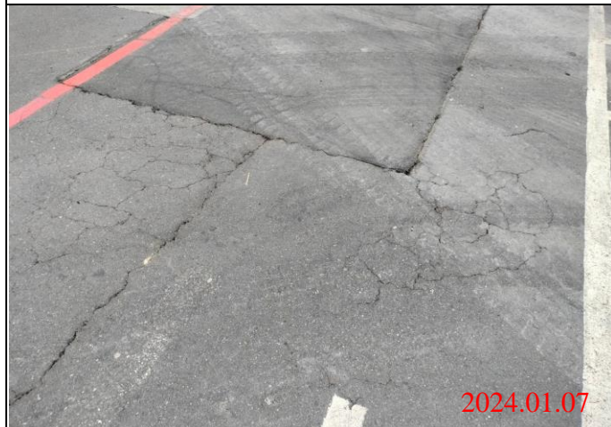
巡查日期地點：113.01.07/ Y23車站 照片說明：路面龜裂狀況
