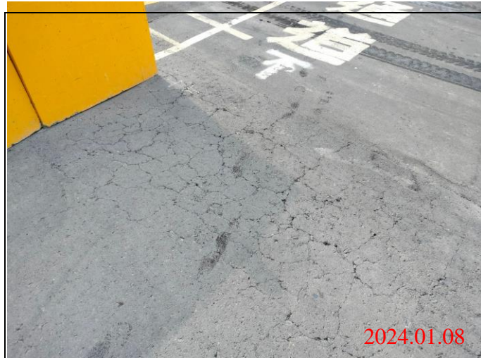
巡查日期地點：113.01.08/ Y23車站 照片說明：路面龜裂狀況
