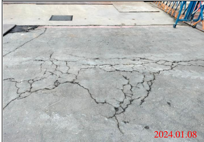
巡查日期地點：113.01.08/ Y23車站 照片說明：路面龜裂狀況
