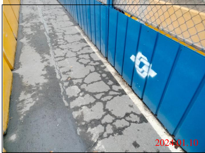
巡查日期地點：113.01.10/ Y23車站 照片說明：路面龜裂狀況
