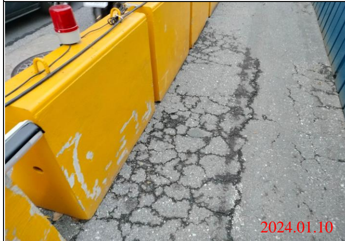
巡查日期地點：113.01.10/ Y23車站 照片說明：路面龜裂狀況
