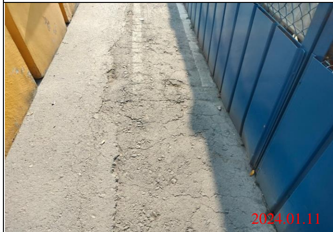
巡查日期地點：113.01.11/ Y23車站 照片說明：路面龜裂狀況
