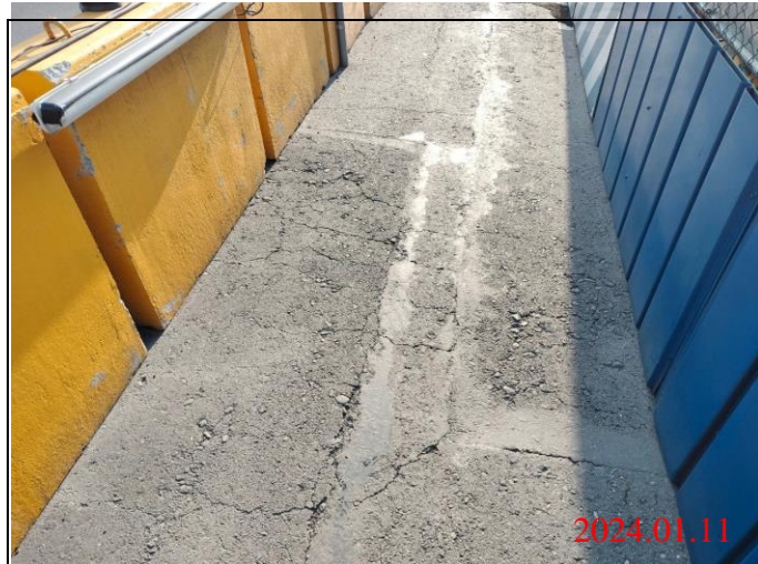
巡查日期地點：113.01.11/ Y23車站 照片說明：路面龜裂狀況
